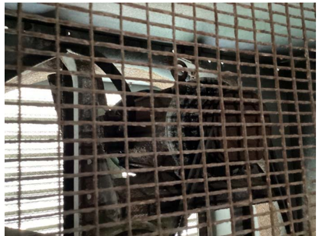
Rust at fan
